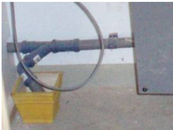
Abbildung 9.46: Provisorische Lösung für das Kondensat (mit Leckströmung)
