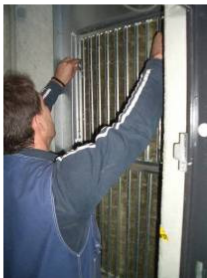
Abbildung 9.37: Großzügig dimensionierter, vor Durchfeuchtung geschützter Filter (F6) vor dem gemauerten (begehbaren) EWT entlang eines unterirdischen Verbindungsganges zwischen zwei Gebäuden
