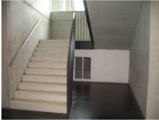
Abbildung 9.56: Ablufführung aus dem zentralen Stiegenhaus spart eine aufwändige Luftleitungsführung für die Abluft
