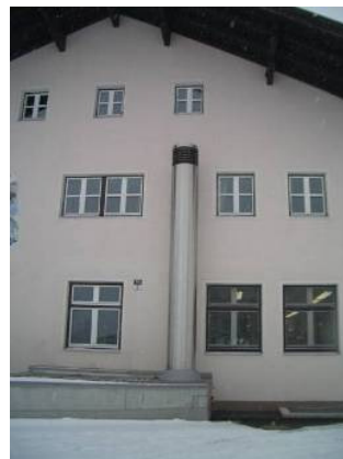
Abbildung 9.26: Eine sehr großzügig ausgeführte Ansaugung einer zentralen Lüftungsanlage mit Erdwärmetauscher
