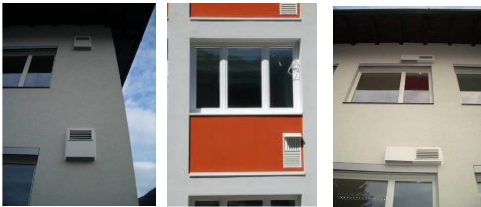
Abbildung 9.35 a–c: Speziell ausgeführte Außenluftansaugung/Fortluftauslass
