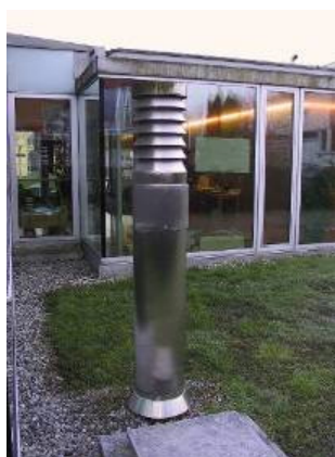
Abbildung 9.27: Ansaugung einer dezentralen Anlage
