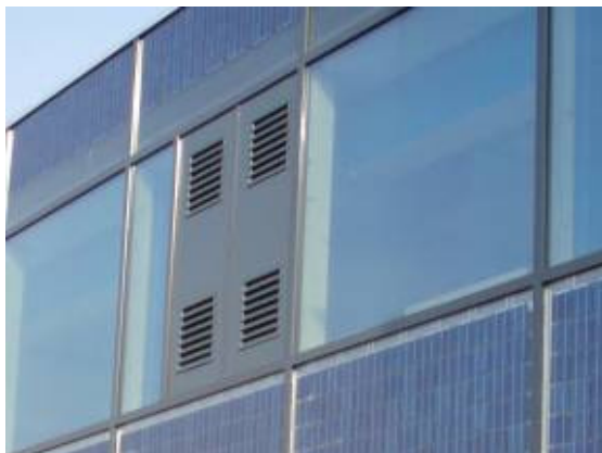
Abbildung 9.32: Außenluftansaugung und Fortluftauslass sind weniger als 2 m voneinander getrennt
