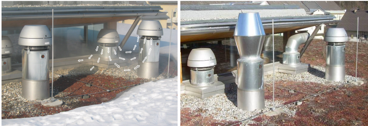
Abbildung 9.33: „Kurzschluss“ zwischen Ab- und Zuluft beim Kaltrauchtest (Quelle: Heiduk, 2008)
