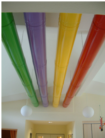
Abbildung 11.1: Beispiel einer gelungenen Integration von Luftleitungen in einem Kindergarten
